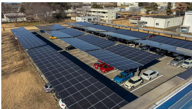
4 号館に設置されたソーラーカーポート
