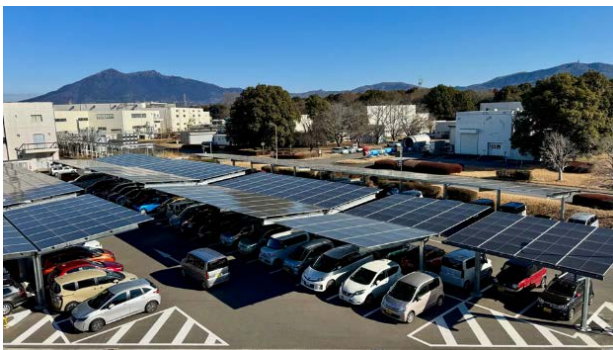
図 1. つくばキャンパス 1 号館駐車場に設置されたソーラーカーポート
