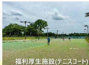
特別高圧受電設備
