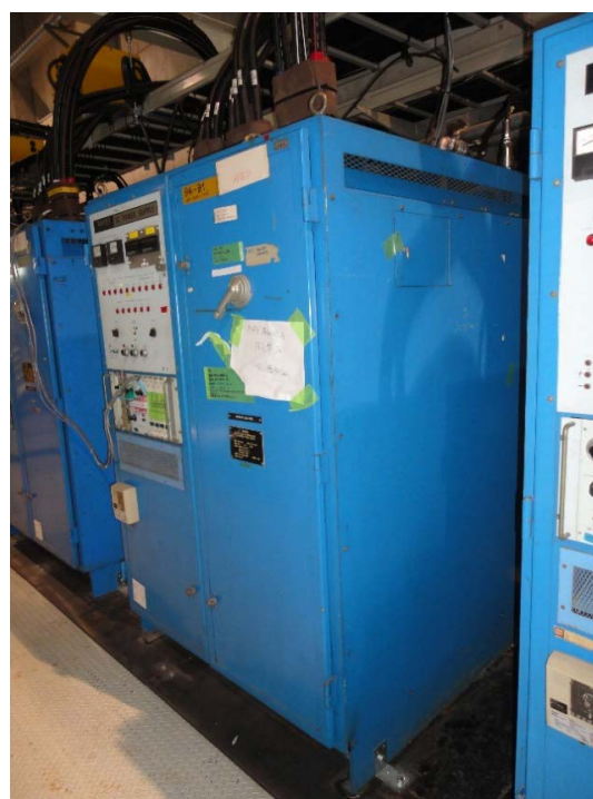
図 1. ハドロン実験施設で使用されていた 1973 年頃製造の 500 kW 直流安定化電源 (出力定格 100V-5000A)
