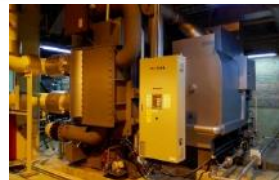
冷温水発生機(H28)
