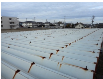
図3.12 塩害被害状況
