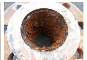
屋外配管腐食
