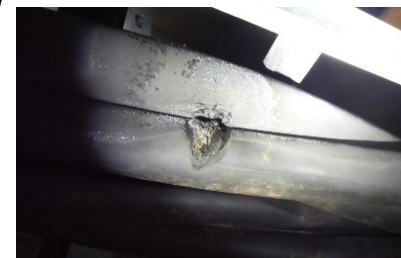
特別高圧ケーブル絶縁不良
