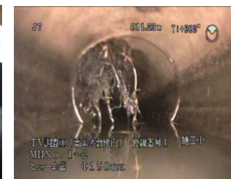
排水管内樹根進入
