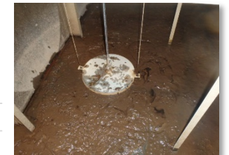
図4.22 工水槽汚泥状況
