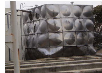
受水槽 ※地震による破損
