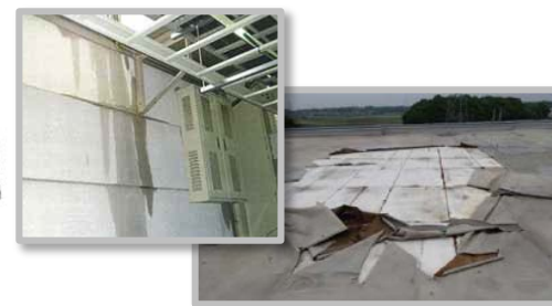
図4.15 雨漏り・防水層劣化
