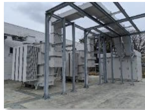
南特高変電設備更新(R1)
