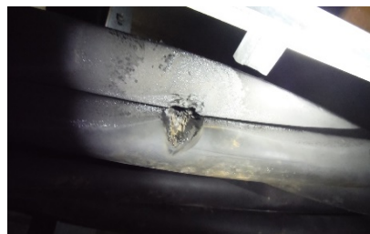
老朽状況 (特別高圧ケーブル絶縁不良)
