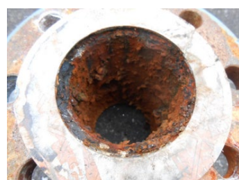
老朽状況 (屋外配管漏水)
