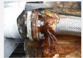
老朽状況 (屋外配管漏水)
