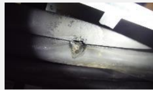
老朽状況 (特別高圧ケーブル絶縁不良)
