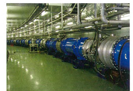
J-PARCニュートリノ実験・一次ビームラインに設置された超伝導磁石システム。一次陽子ビームを二次粒子発生用ターゲットに導き、ニュートリノをスーパーカミオカンデにむけて送りだします
