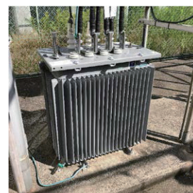
更新後（容量 75 kVA）
