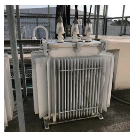
更新前（容量 150 kVA）
