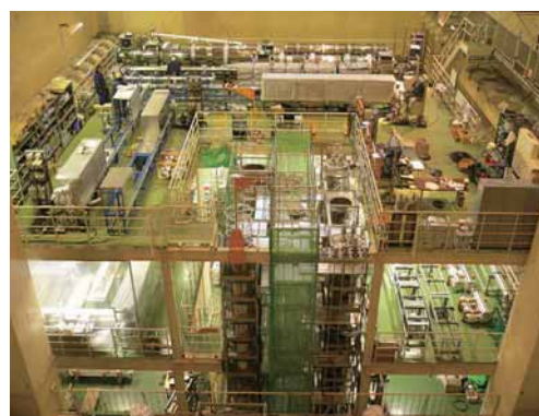
図 4：大穂実験棟に整備したビームパイプ処理設備。上層階（B2）はベーキング及び横型コーティング装置、中層階（B3）は組立て及び検査、下層階（B4）は保管場所として使用。手前側、B2 から B4 まで貫通して 5 基の縦型コーティング装置が設置されている。
