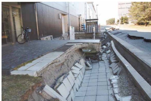
写真 1. リニアック棟エントランス前の陥没
