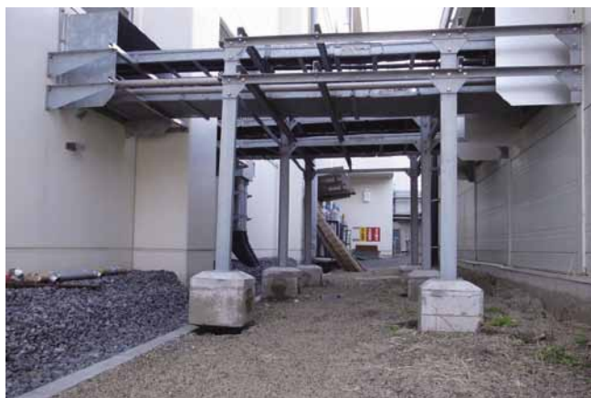
写真 7. ハドロン実験ホール周辺の地盤沈下により浮き上がった架台の基礎部分
