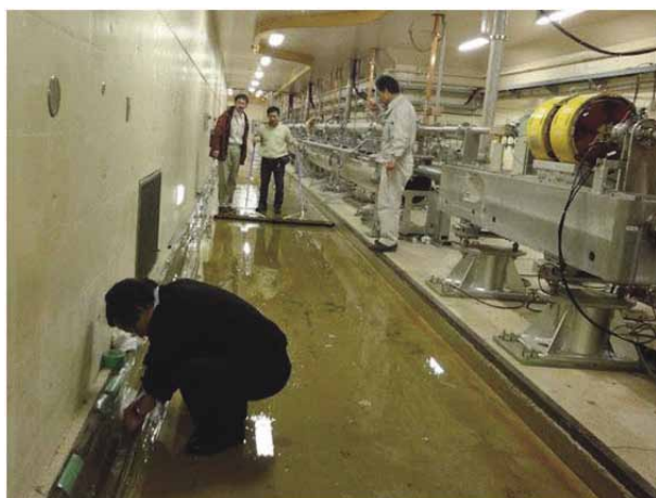
写真9. 電子陽電子入射器棟トンネル内の漏水
