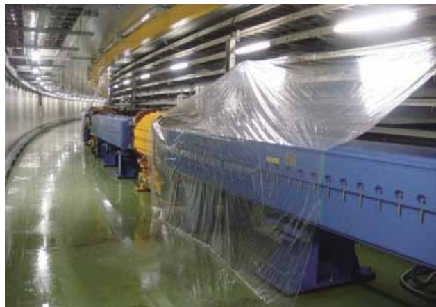
写真4. MR トンネル内の地下水漏水 (照明の復電後、電磁石にビニールシートをかけた)
