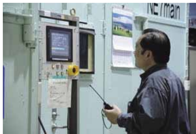
写真 12. PF-AR で、放射光導入前に安全装置 (インターロック) 動作試験を行っている様子
