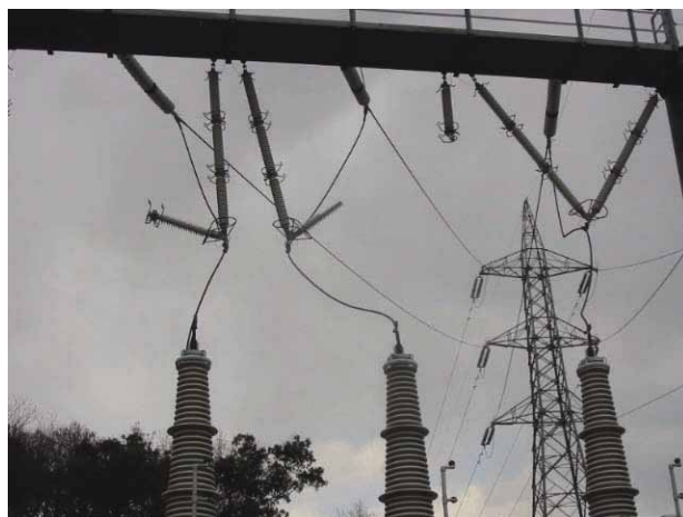
写真8. 地震直後の特高受電部碍子の破損
