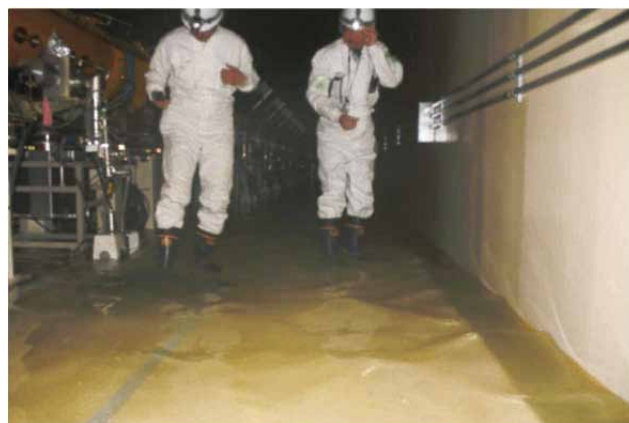
写真 2. リニアック棟トンネル内の漏水
