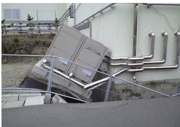
写真 6. 地盤沈下により傾いた空調屋外機と破断した配管（ニュートリノ実験施設 TS 棟）
