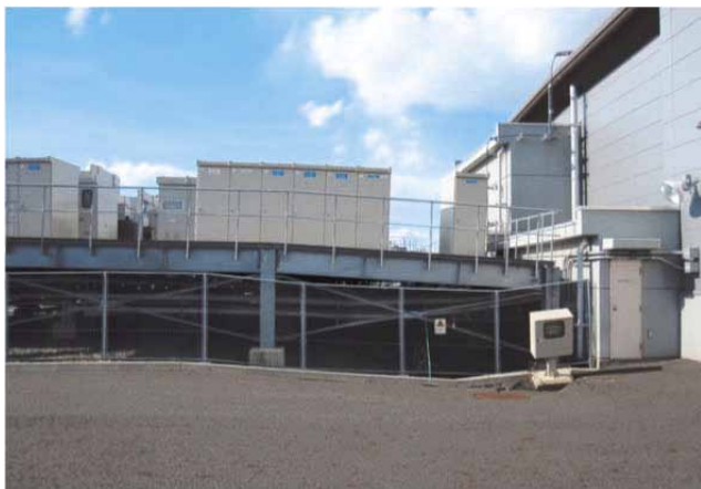
写真3. 大きく傾いた受電ヤードと高圧受電盤 (RCS 棟屋外ヤード)
