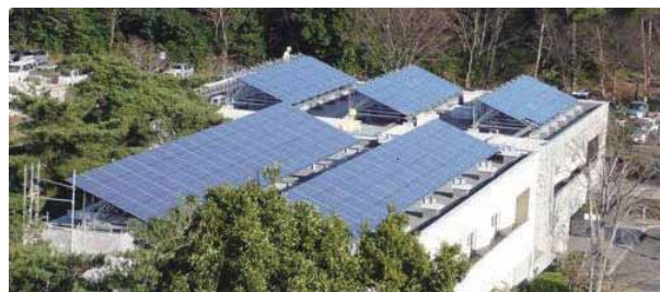
管理棟屋根太陽光パネル設置状況
