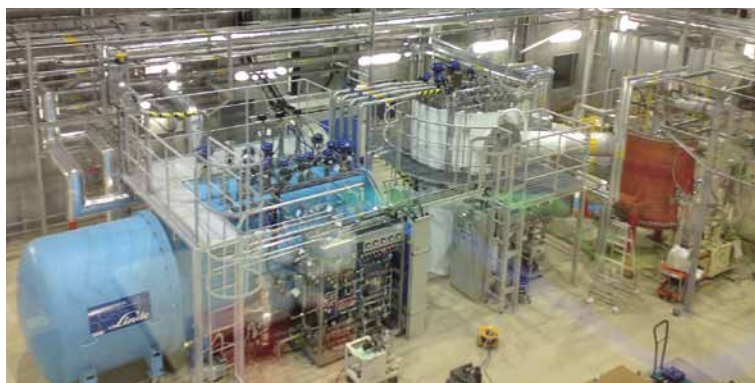
節電モードを実現したヘリウム冷凍機の外観 (左からコールドボックス (水色)、超臨界ポンプ (白色)、 地下トンネルにつながるトランスファーライン (茶色))
