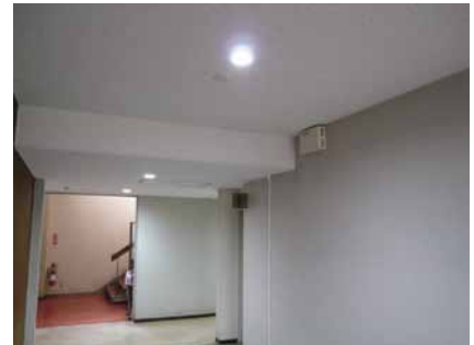
管理棟廊下LED照明
