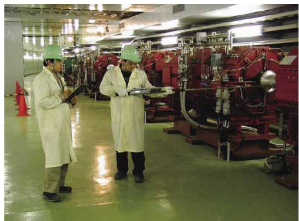
運転停止後に機器に残っている放射能（ガンマ線）を、被ばくを避けるために離れた位置から測定します。
