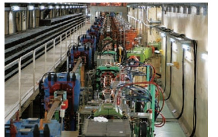
KEKBトンネル
