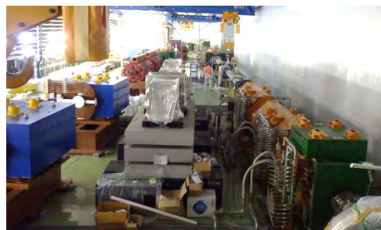
スイッチヤード（最下流部から上流方向を撮影）
