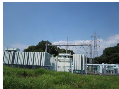
KEK中央受電棟
