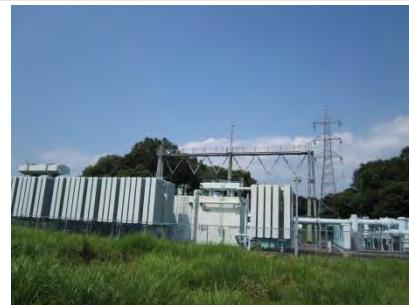
KEK中央受電棟
