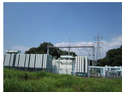
KEK中央受電棟
