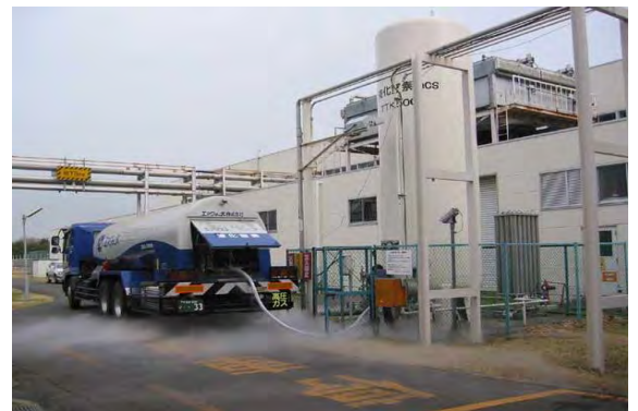
液体窒素をローリー車からタンクに充填している様子
