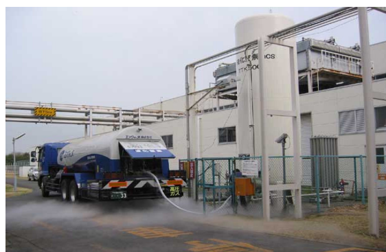
液体窒素をローリー車からタンクに充填している様子
