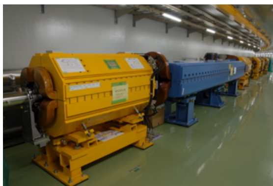
J-PARCの50GeV加速器トンネル内で設置が進む電磁石群
