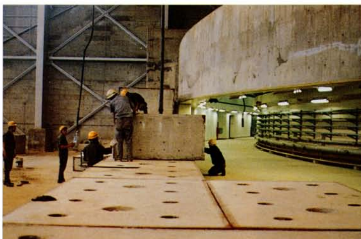
遮蔽ブロック積上げ中のカウンター実験ホール Shield blocks are piled up in the experimental hall.
