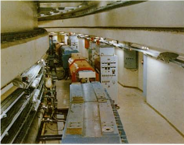
主リング高周波加速装置 The rf equipment for the Main Ring.
