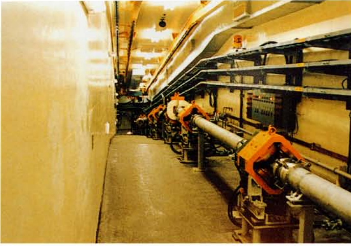
ブースターダンプライン Booster dump beam line.
